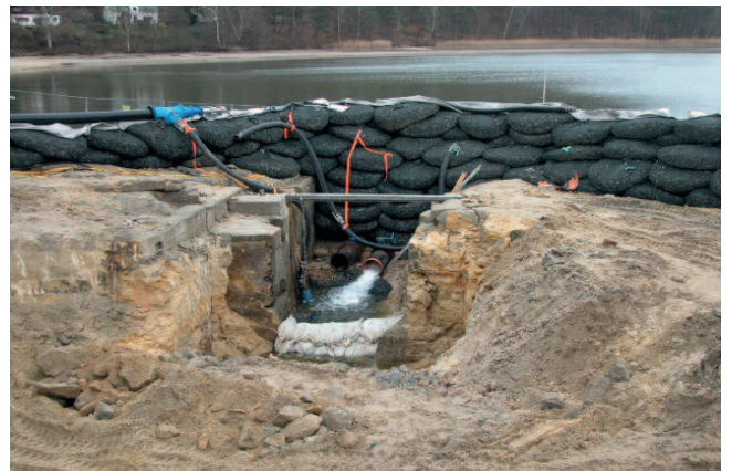
Máchovo jezero - vlastní rekonstruované výpustní zařízení
