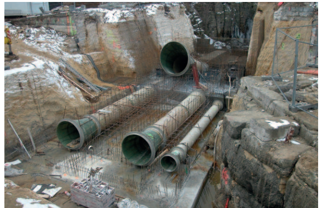
Máchovo jezero - vlastní rekonstruované výpustní zařízení
